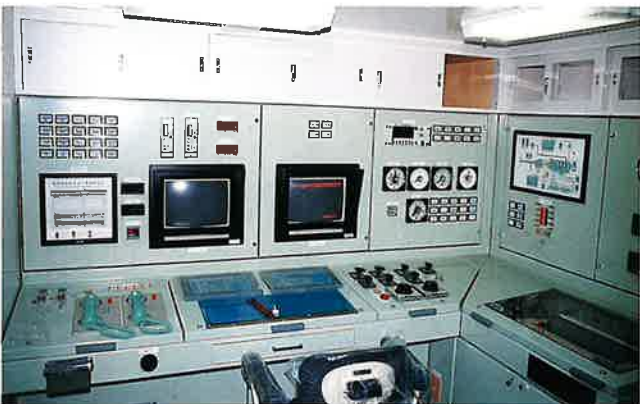
監視室 監視盤
