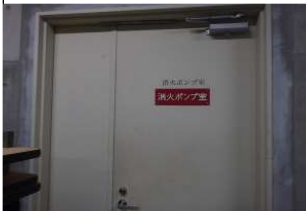
消火ポンプ室
