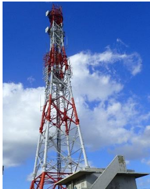
伊良部中継局外観
