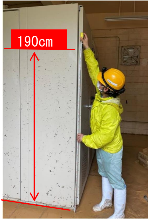
※平南取水ポンプ場浸水状況
