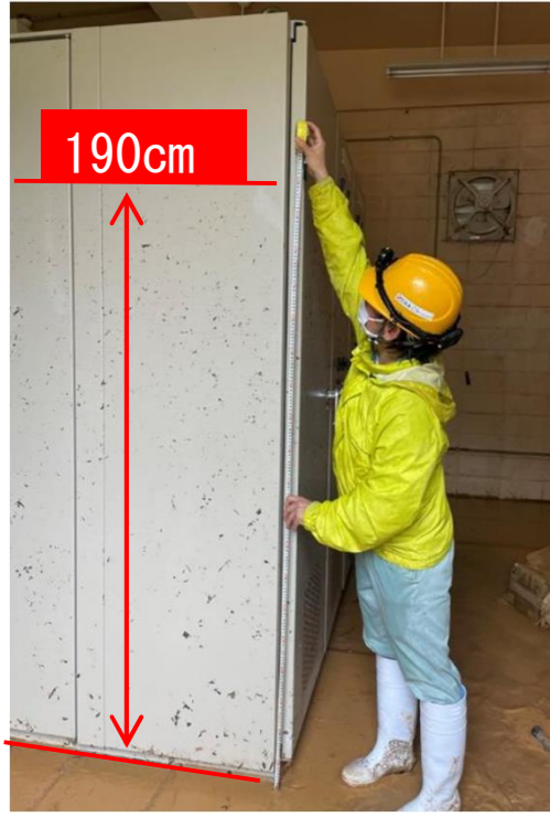
※平南取水ポンプ場浸水状況
