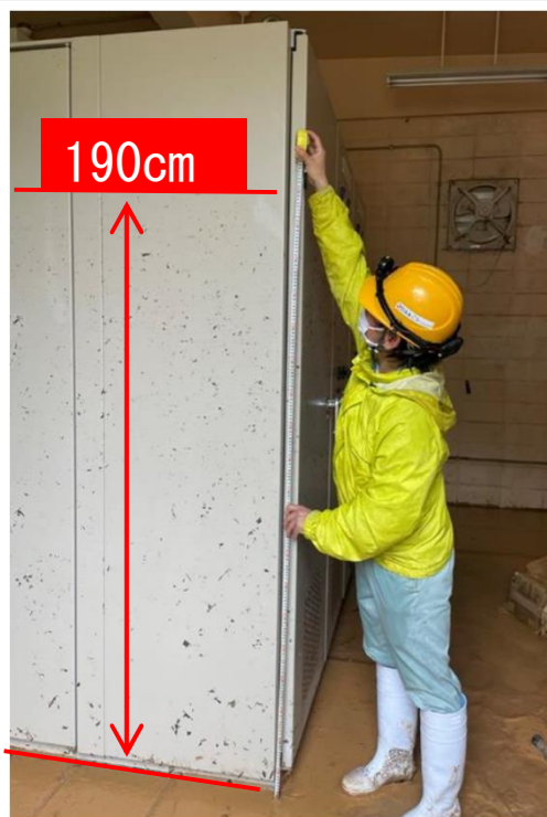
※平南取水ポンプ場浸水状況
