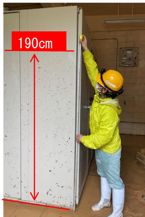
※平南取水ポンプ場浸水状況
