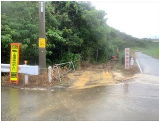
宜野座福地川河口海域 新規造成地から濁水発生(今年度(R3年度))
