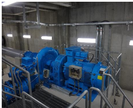
大湾小水力発電設備
