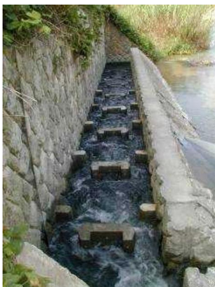
取水施設に設置した魚道
