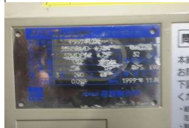
上水加圧ポンプ(プレート)
