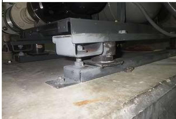
上水加圧ポンプ(防振架台)
