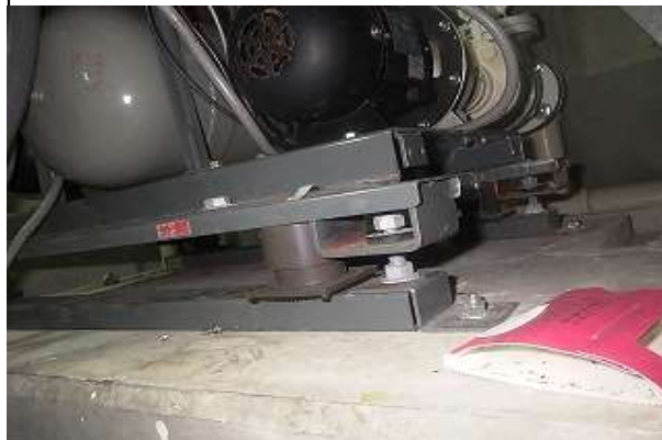
中水加圧ポンプ(防振架台)
