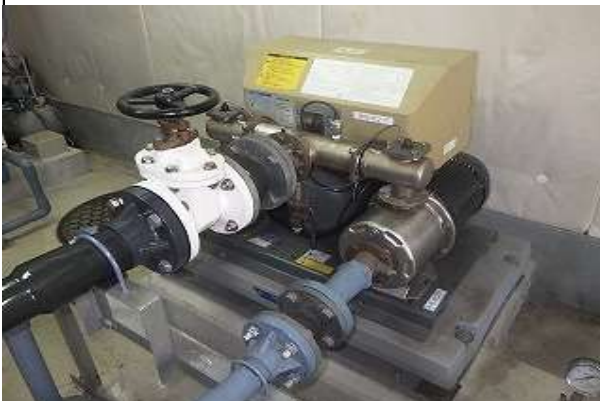
散水加圧ポンプ(本体)
