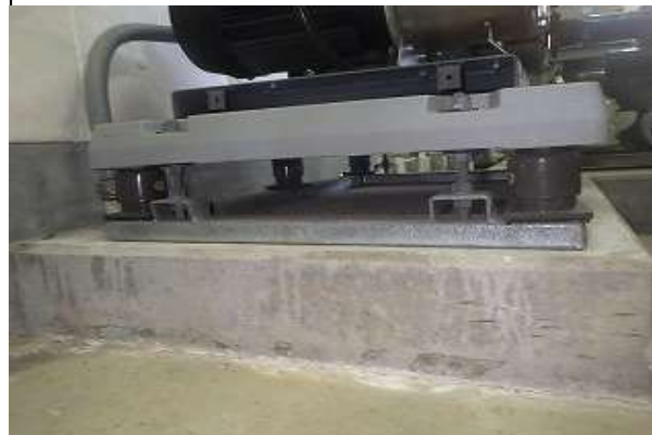
散水加圧ポンプ(防振架台)
