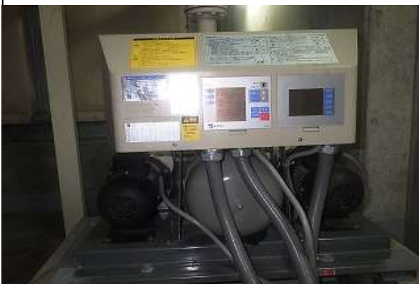
上水加圧ポンプ(本体)
