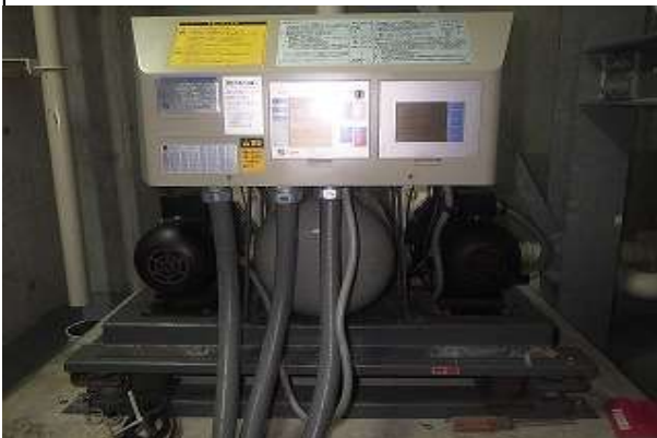
中水加圧ポンプ(本体)
