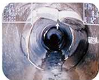
げすいどうかん はそん 下水道管の破損など
