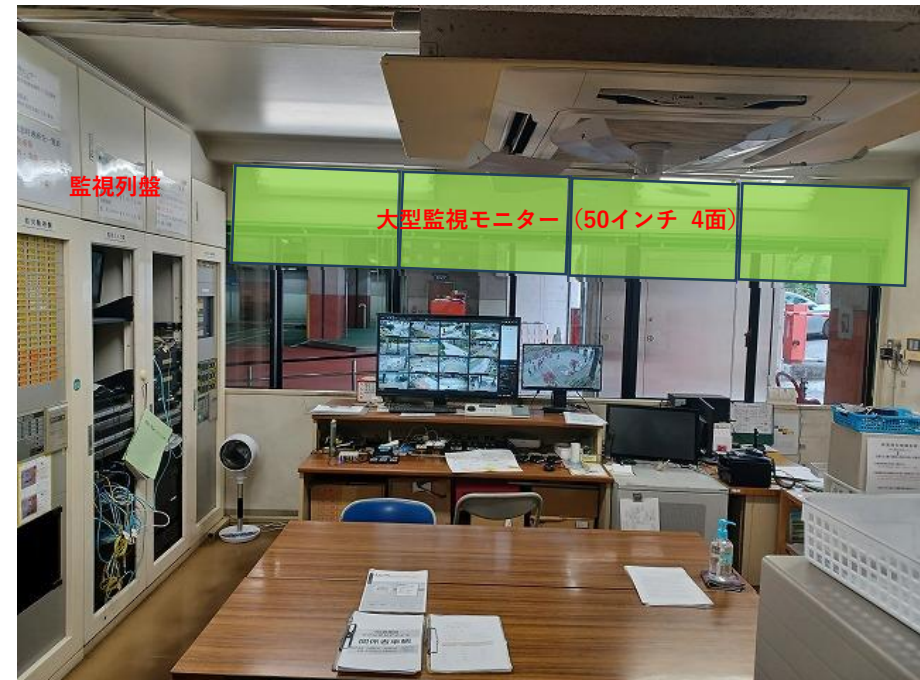
新防災監視室 機器配置イメージ
