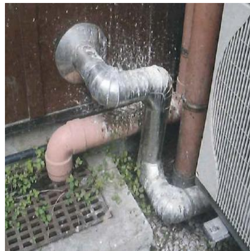
配管周辺の糞害
