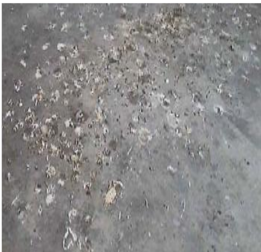
〇〇駐車場の糞害
