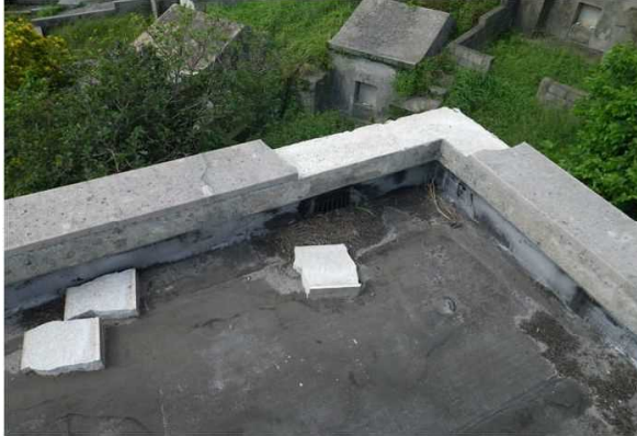
写真. 屋上パラペット笠木の剥落
