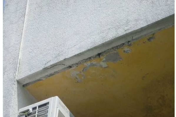
写真. ベランダ床の剥離
