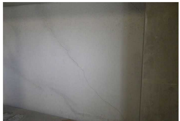
写真. ひび割れ遠景
