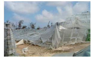
園芸施設の被害
