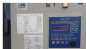
環境制御盤の導入
