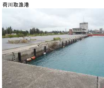
地震に対して脆弱な岸壁
