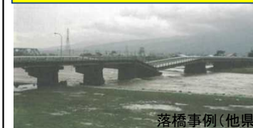
落橋事例(他県)
