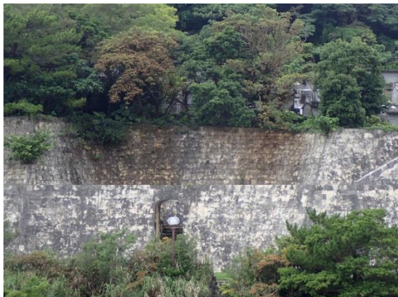
写真 1-3 構造物への被害（汚れ）
