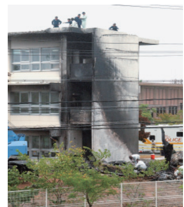
黒くこげた校舎の壁(8月17日) (写真提供：琉球新報社)
