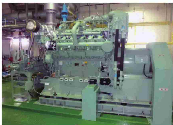
消化ガス発電機
