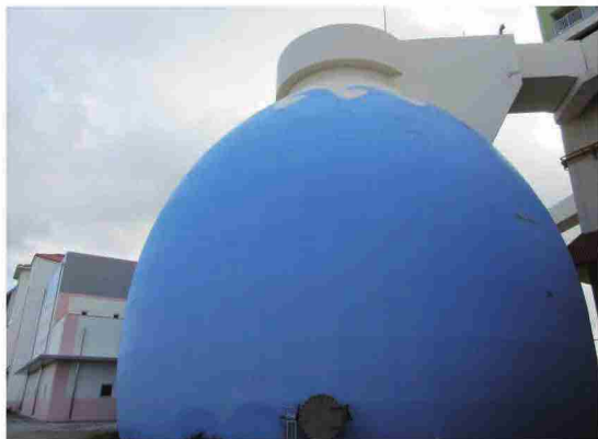
汚泥消化タンク
