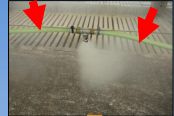
高圧ホースとワイヤー
