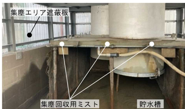
改造後（集塵部）
