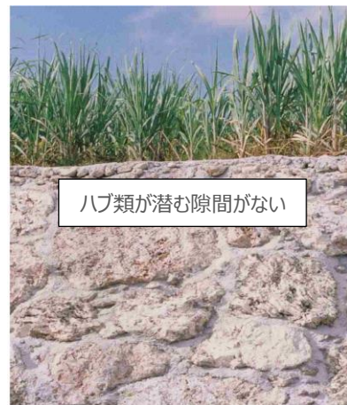
穴埋めした石積み
