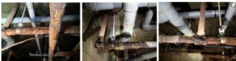
【図表 2-1-6】 給水配管の腐食状況
