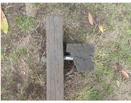
事故発生状況
