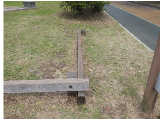
事故発生状況
