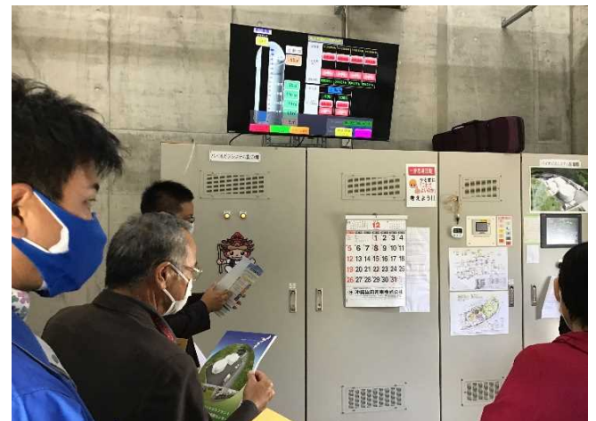
八重瀬堆肥センター③ バイオガスプラントシステム
