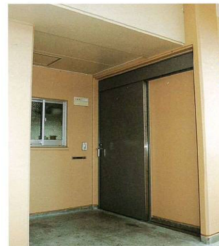
車椅子対応住戸 車椅子での出入りを考慮した、引戸式の開口の広い玄関ドア
