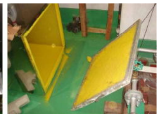
集塵機のフィルター状態
