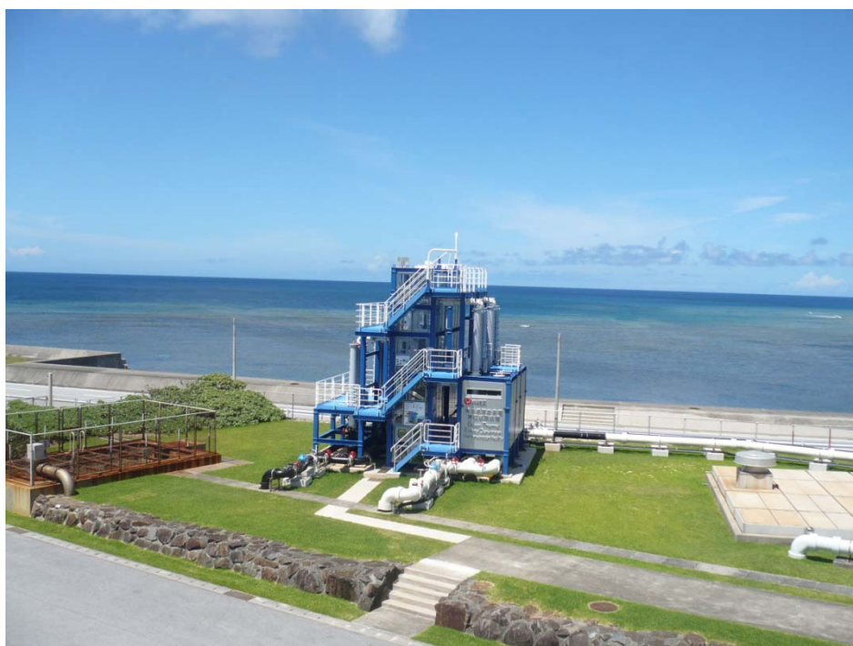
図 1-1 沖縄県海洋温度差発電実証設備
