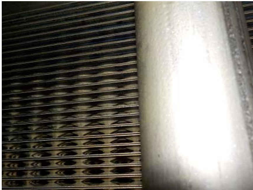
図 2-14 ユニット B 凝縮器 プレートバンドル入口
