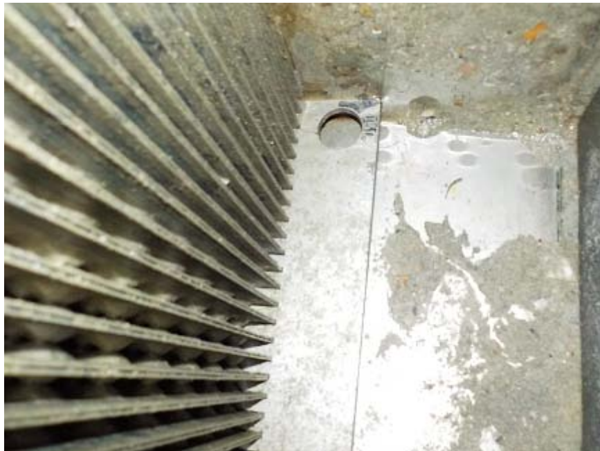
図 2-16 ユニット B 凝縮器 プレートバンドル入口下部
