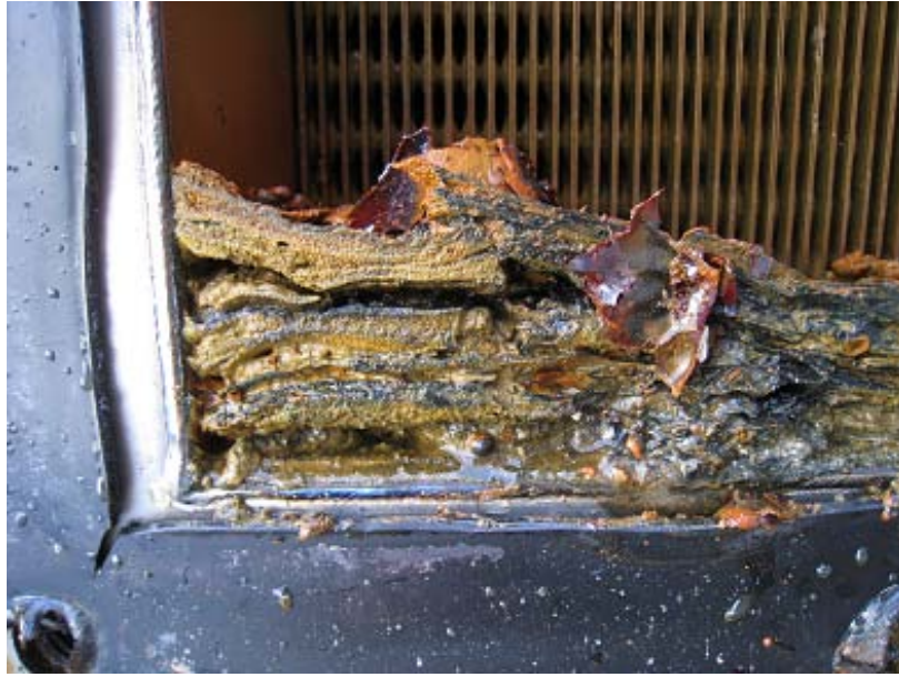
図 2-7 ユニット A 蒸発器プレートバンドル入口下部の土の堆積①(洗浄前)
