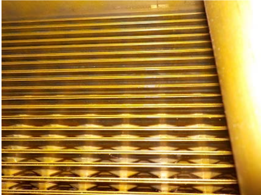
図 2-11 ユニット B 蒸発器 プレートバンドル部入口
