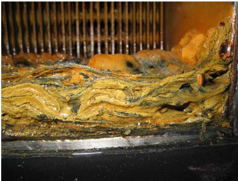
図 2-8 ユニット A 蒸発器プレートバンドル入口下部の土の堆積②(洗浄前)
