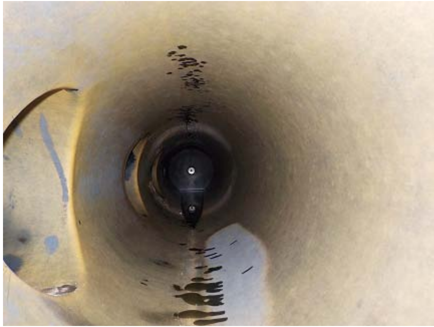
図 2-13 ユニット B 蒸発器 海水ヘッダ配管内
