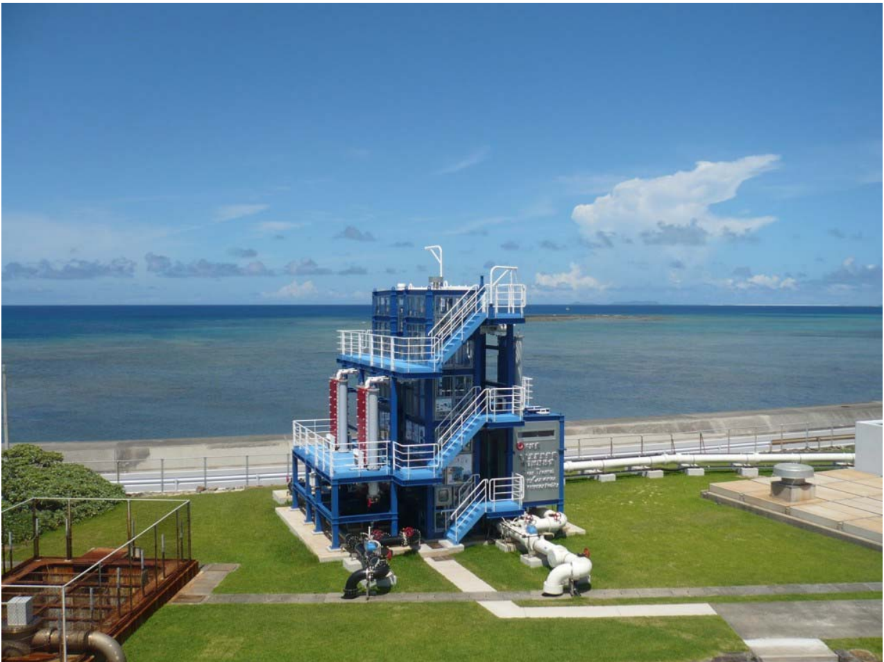
久米島の海洋温度差発電実証実験プラント
