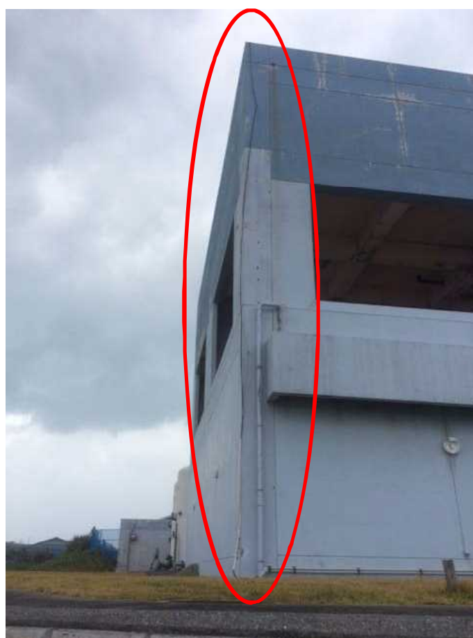
図 2-18 【写真】平成 26 年 10 月 台風による信号ケーブル破断
