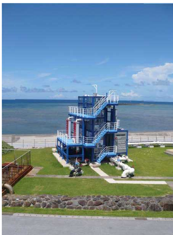
図 1-11 沖縄県海洋温度差発電実証設備
