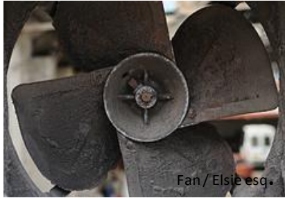
換気扇の汚れにも注意
