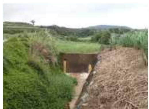
儀間川河口 沈砂池からの濁水流出 (平成 27 年度)
