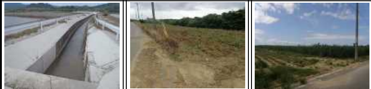
③ 昨年度状況 ④ サトウキビ畑から道路へ赤土等の流出 ⑤ パイナップル畑から道路へ赤土等の流出
