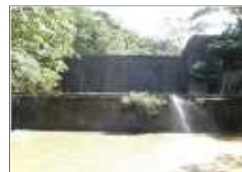
③ 砂防ダム
