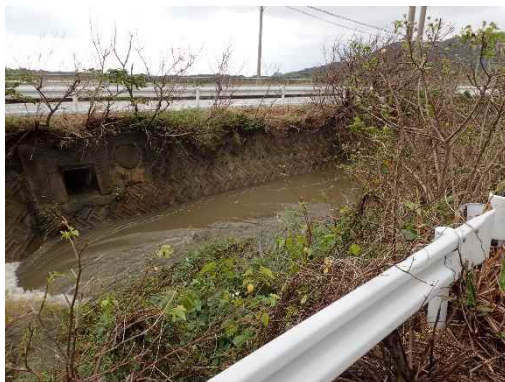
地点⑧ 本線を流れる濁水
