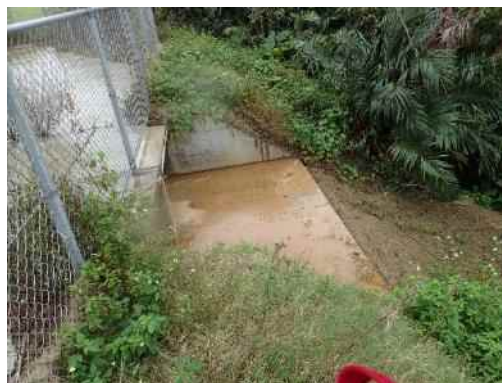
地点④ 農業用水池排水口
