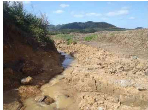
宮良川河口 圃場工事による濁水流出(今年度)
