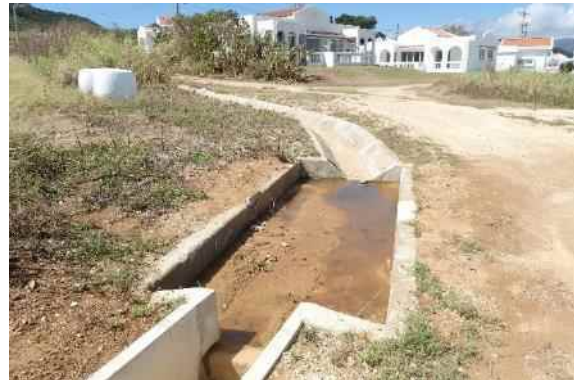
地点⑥ 浸透池直前水路(泥が堆積)
