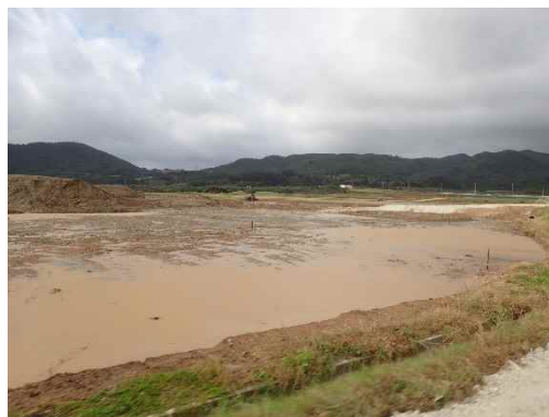
地点② 工事地にたまる濁水(流出少)
