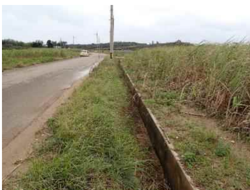
地点⑨ 道路への赤土流出(変化無し)
