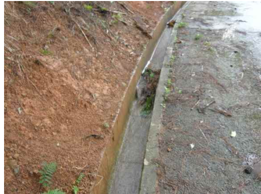
地点⑦ 法面から水路への流出
