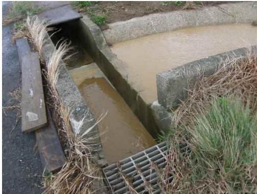
地点⑥ 水路にたまる濁水
