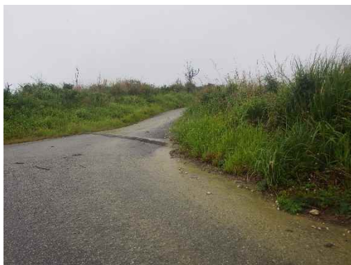
地点③ 道路への流出痕
