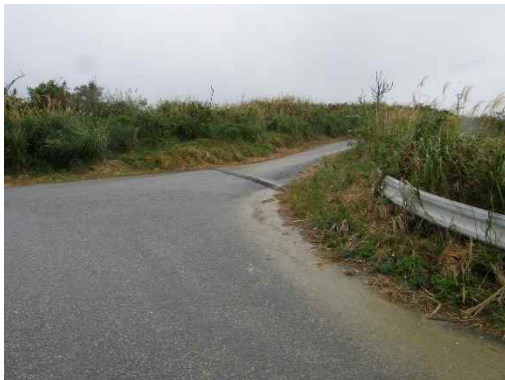
地点③ 道路への流出痕
