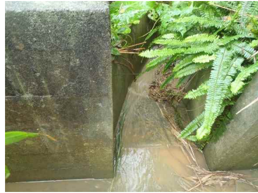
地点② 沈砂池から流出する濁水
