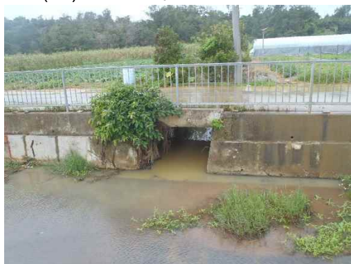
地点⑨ 本川へ濁水が流出する水路
