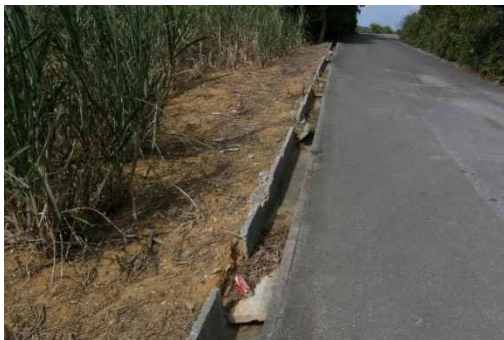
地点⑦ 側溝が損壊し赤土流出
