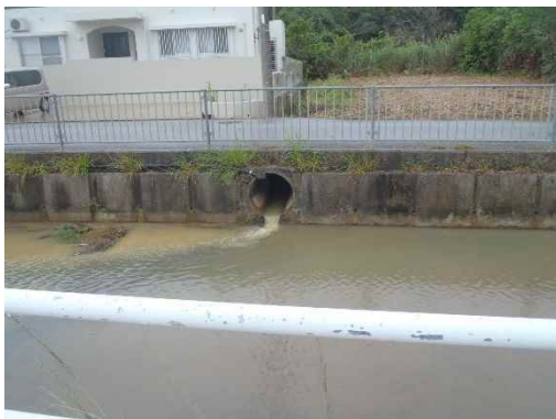
地点③ 本川へ濁水が流出する水路
