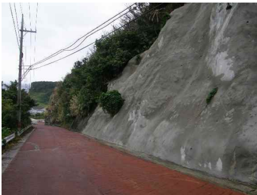
地点⑨ 地すべり発生後の対応状況
