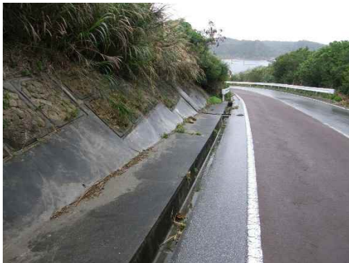
地点⑥ 道路への濁水流出可能性があった水路
