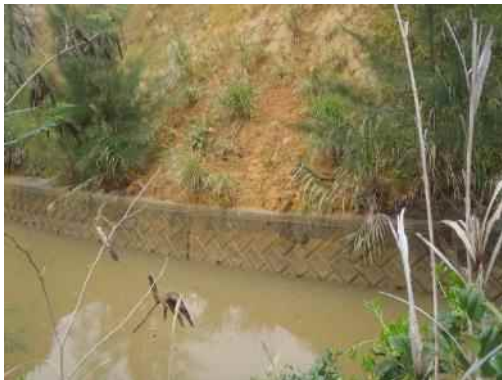
地点⑤ 崩落斜面跡
