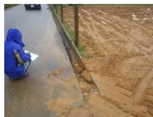
地点⑨ 新規造成地から水路に流出する赤土
