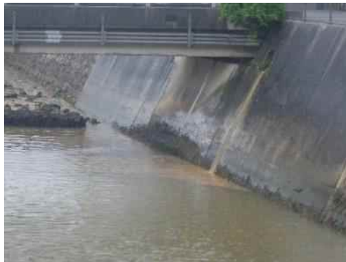
地点② 下流域(濁り少)に流れ込む濁水
