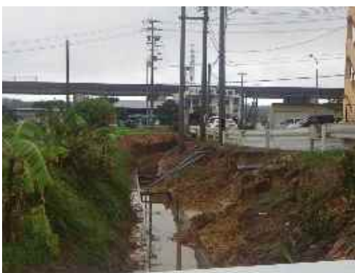
地点⑧ 法面の土砂が水路への流出
