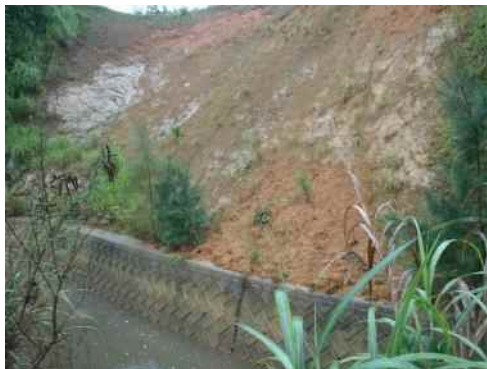
地点⑤ 崩落斜面跡
