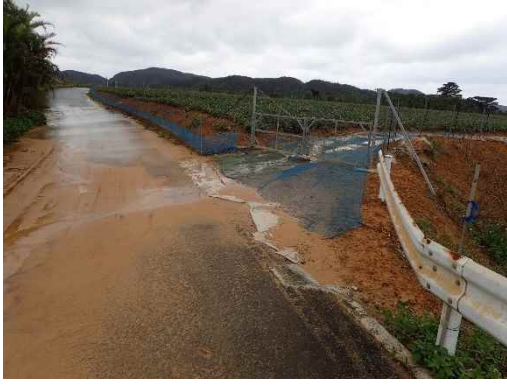
地点⑩ 畑からの土砂流出(変化無し)
