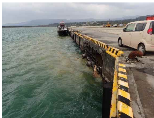
地点① 海域への流出(濁り有り)
