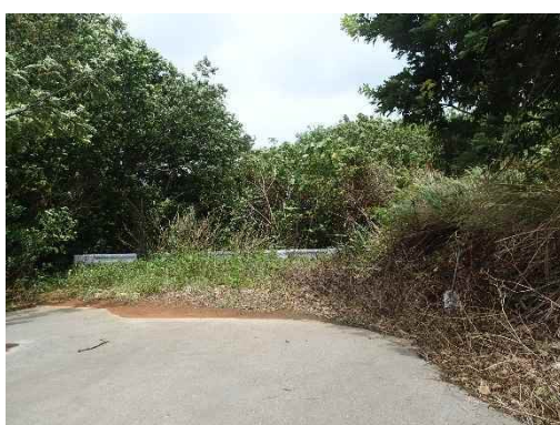
地点④ 道路への流出状況(変化無し)
