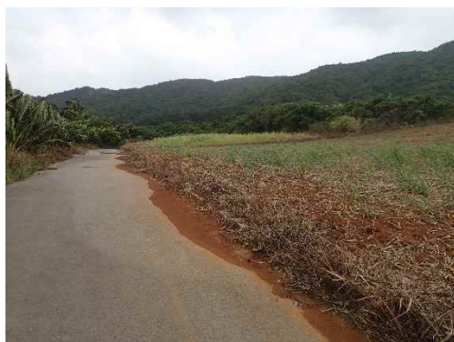
地点③ 道路への流出状況(悪化)
