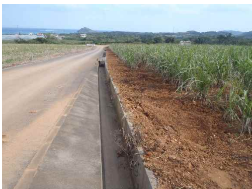
地点⑥ 畑から側溝への流出痕(悪化)
