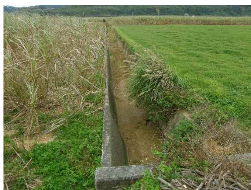
地点④ 河口近くの水路に堆積する土砂
