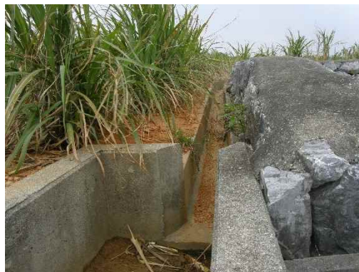
地点⑪ 沈砂池直上の水路に堆積する赤土
