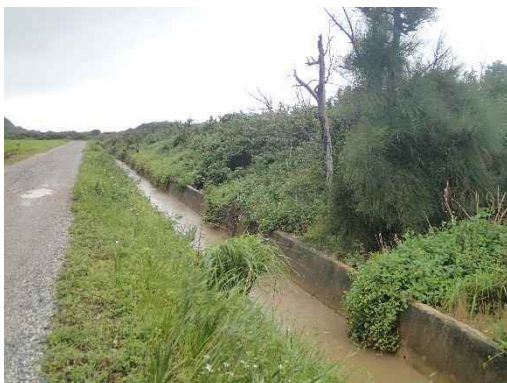
地点③ 河口近くの水路に流れる濁水と壁の流出痕
