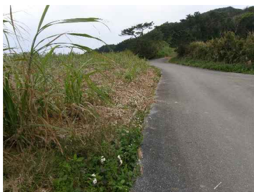
地点⑫ 土砂により埋もれた水路(変化無し)
