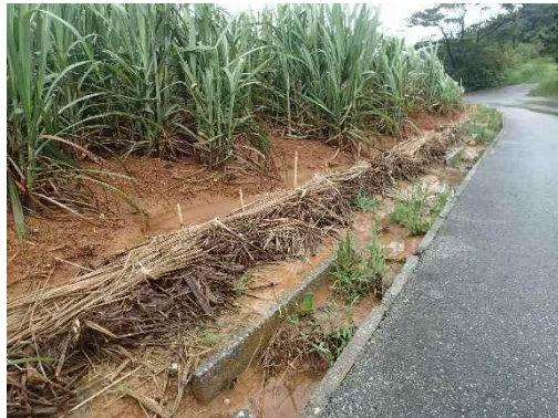
地点⑭ 赤土流出防止対策と側溝の決壊
