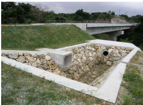
地点⑫ 沈砂池による対策(底に土砂堆積)
