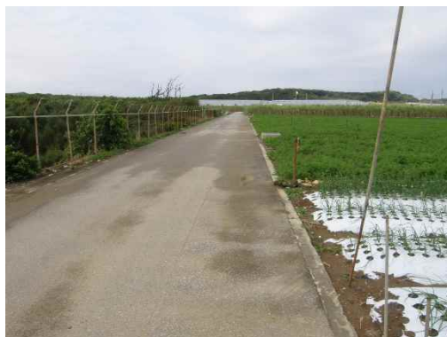
地点⑨ 流出可能性が高い箇所(変化無し)
