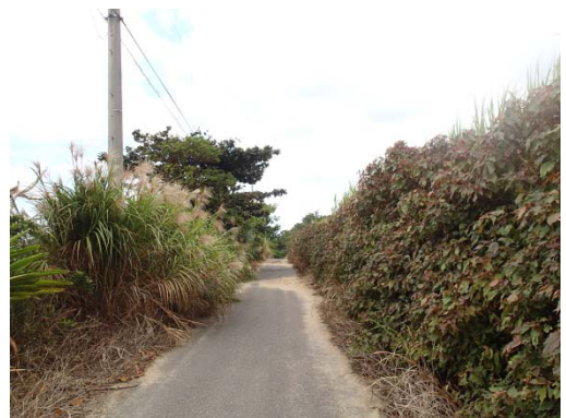
地点 道路への流出痕
