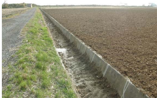
地点 水路内に泥分堆積(1 回目地点 )
