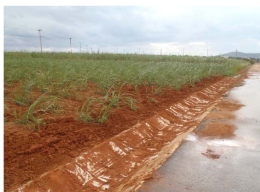
地点 流出痕がある箇所
