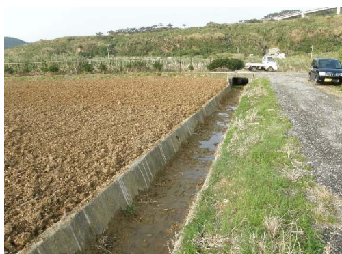
地点 水路内に泥分堆積(1 回目地点 )
