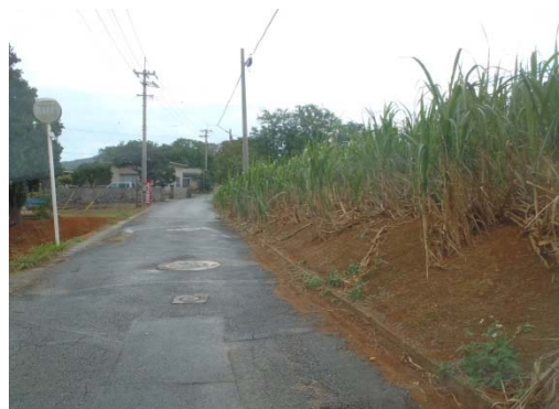
地点 流出痕がある箇所
