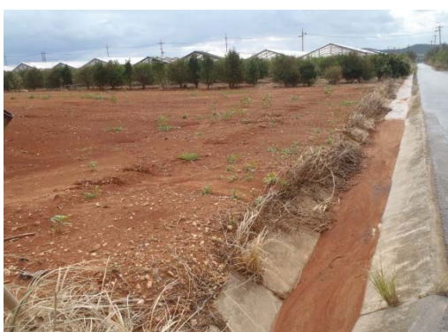
地点 流出痕がある箇所
