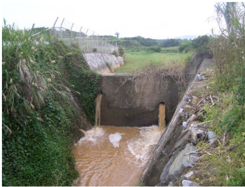
儀間川河口 沈砂池からの濁水流出 (平成 25 年度)
