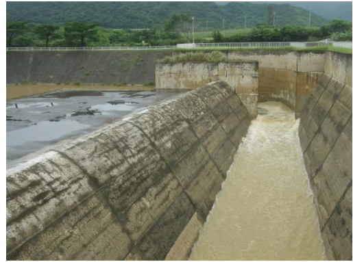
宮良川河口 真栄里ダムからの濁水流出 (平成 25 年度)
