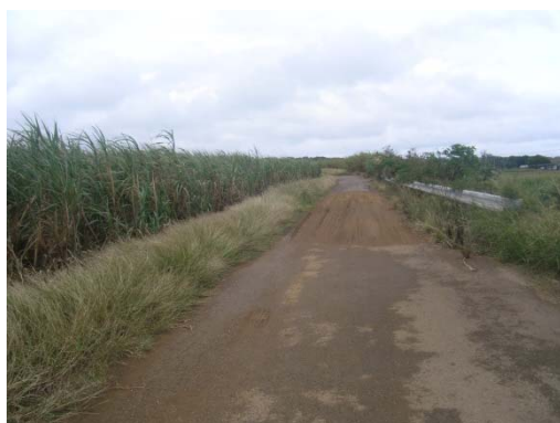
地点 赤土等流出痕有り
