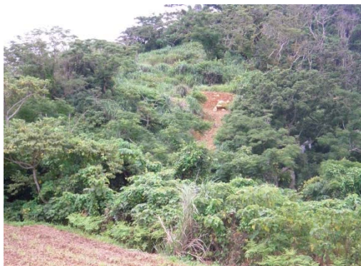
地点 造成に伴う土砂崩れ箇所
